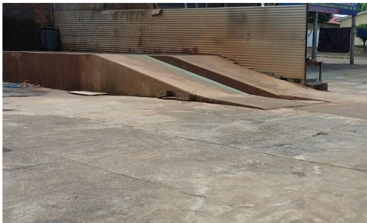
Figura 2: Estrutura e piso impermeável em um empreendimento de lavagem de veículos no município de Jaru. Fonte: Faria, M. L. C. (2015).
