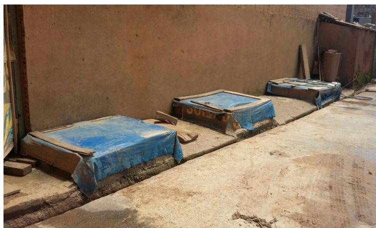
Figura 1: Caixas separadoras de água e óleo em um empreendimento de lavagem de veículos no município de Jaru. Fonte: Faria, M. L. C. (2015).
